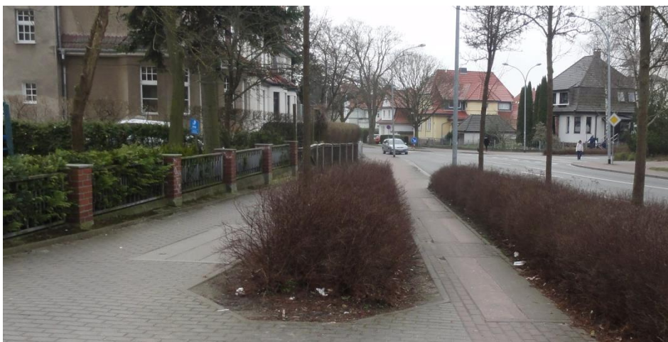
Foto: Beispiel für eine veraltete Anlagen: Knieperdamm, Unterschreitung der Mindestbreite von 1,60 m um 0,60 m, nicht als Radverkehrsanlage beschildert, demnach „Radweg ohne Benutzungspflicht“
