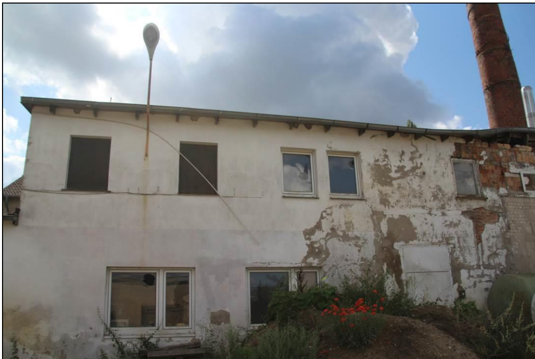
Abbildung 38: Nicht mehr genutzte Mehlschwalbennester an der Ostfassade des Gebäudes 1b.
