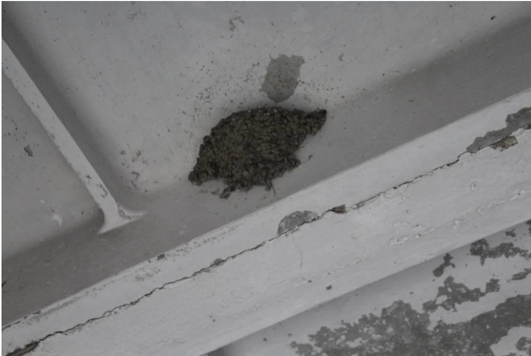
Abbildung 45: Rauchschalbennest im Gebäude 1c.
