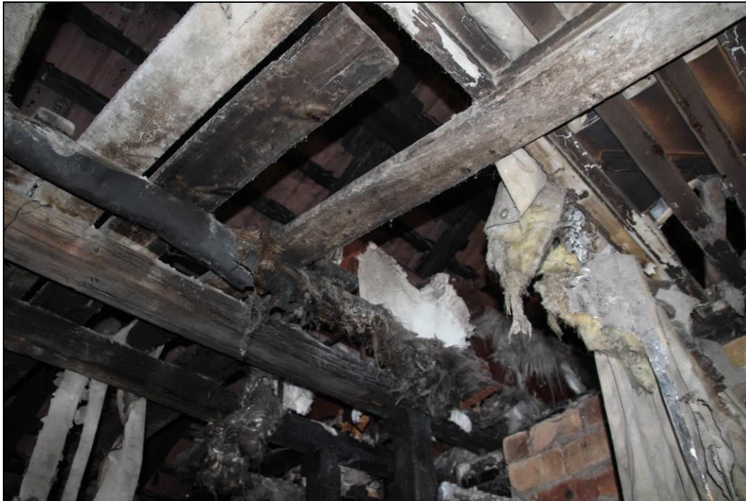
Abbildung 7: Brandschaden im Dachbereich des Gebäudes 1b.
