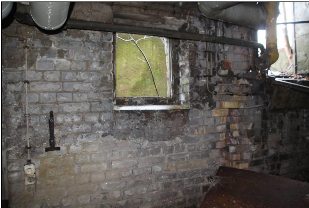
Abbildung 33: Der Keller des alten Heizhauses der ehemaligen Gärtnerei (17. Februar 2021) steht unter Wasser.
