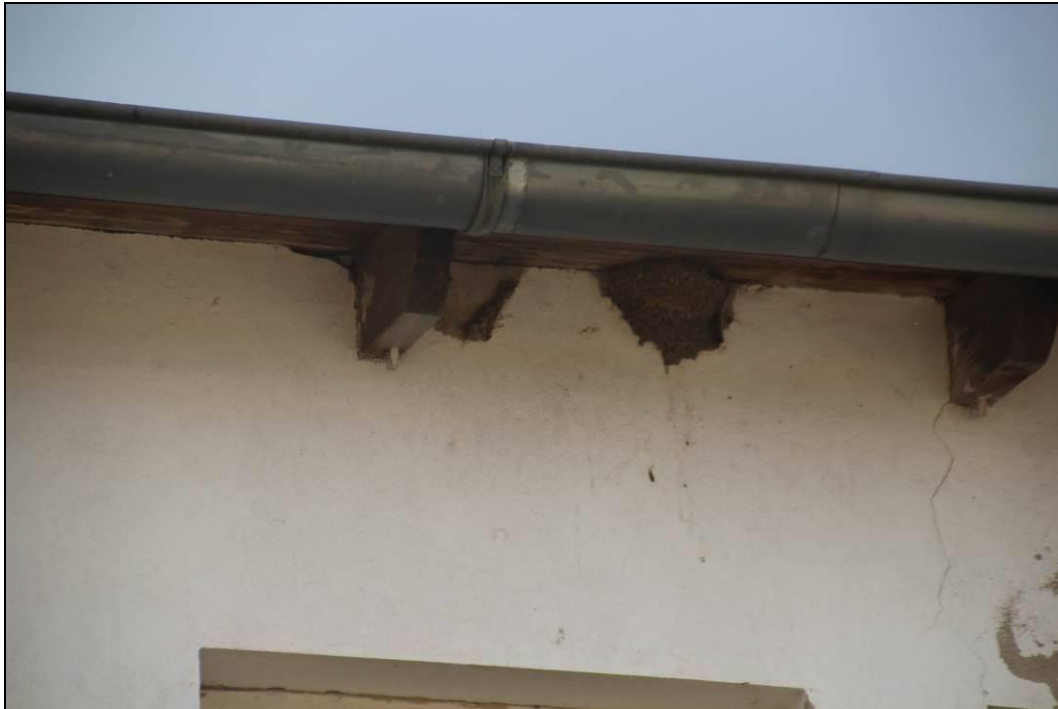
Abbildung 39: Mehlschwabennest an der Ostfassade des Gebäudes 1b. Dieses Nest wurde im Jahr 2020 nicht mehr genutzt. Offenbar ist der Parasitenendruck zu groß.
