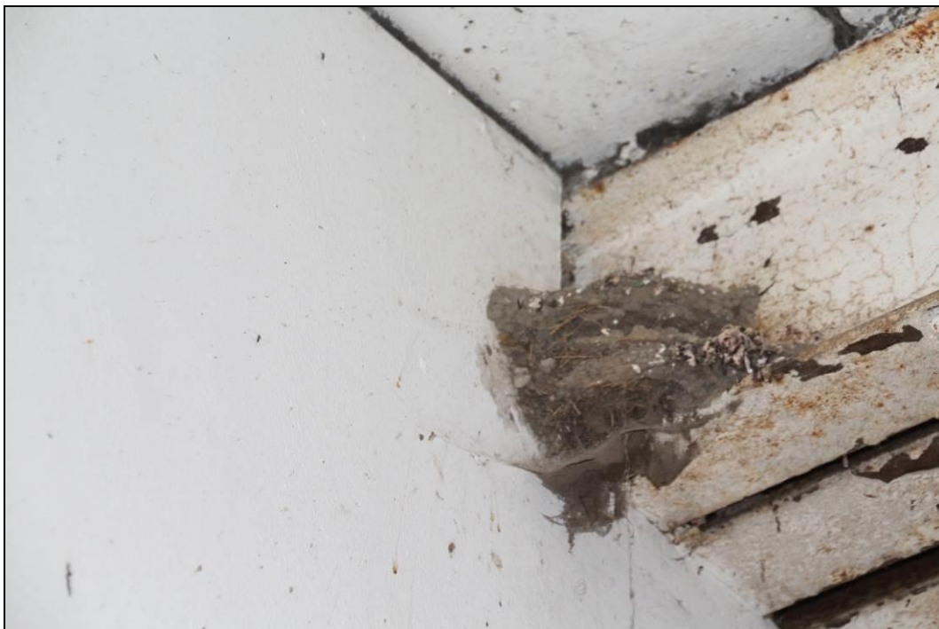
Abbildung 40: Rauchschwabennest im alten Heizhaus der ehemaligen Gärtnerei (Gebäude 5).
