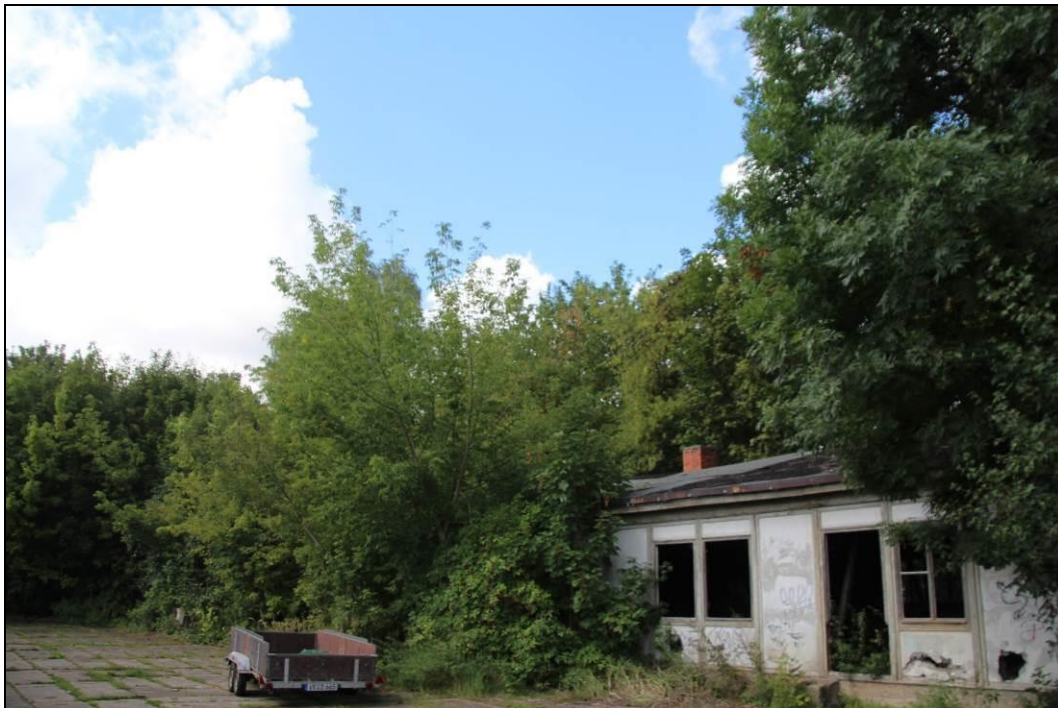
Abbildung 16: Halle des Gebäudes 2e, die ebenfalls fast vollständig von Gehölzen umwuchert und teilweise eingestürzt ist.
