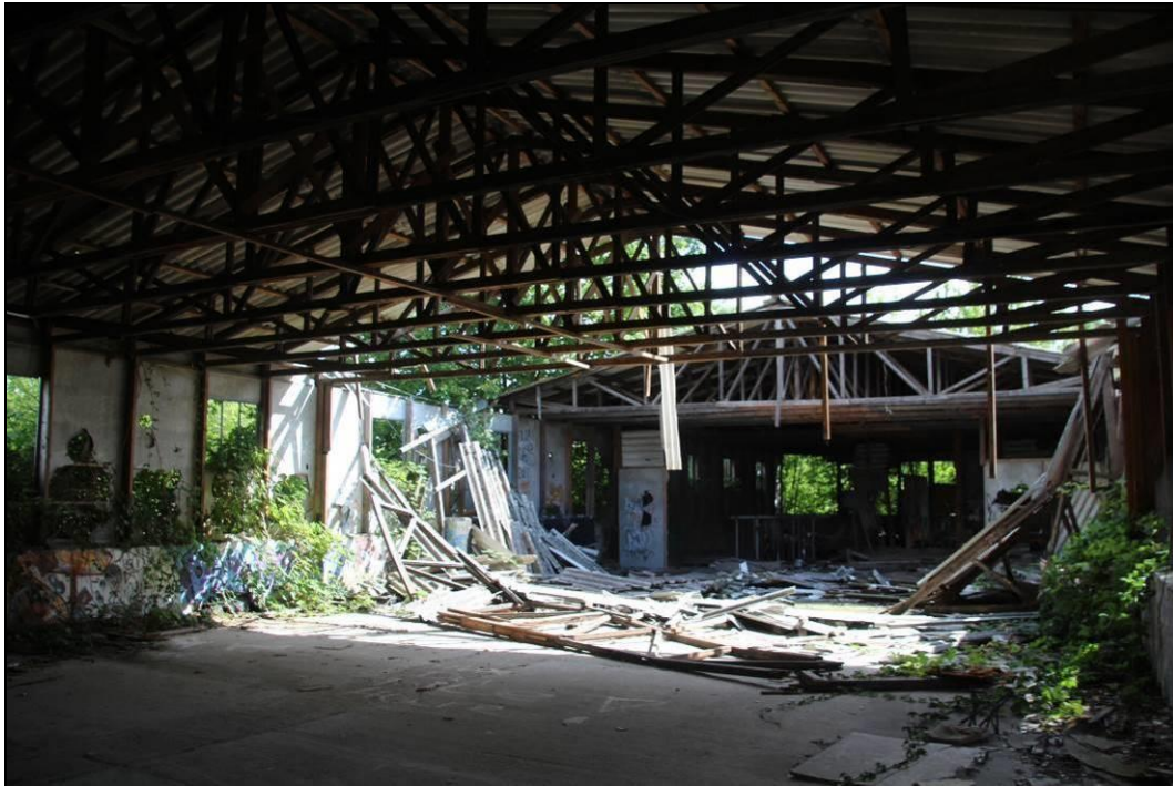
Abbildung 15: Einstürztes Dach einer Halle des Gebäudes 2c.
