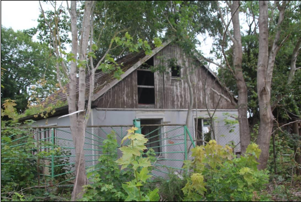
Abbildung 17: Gebäude 3 im ruinösen Zustand.
